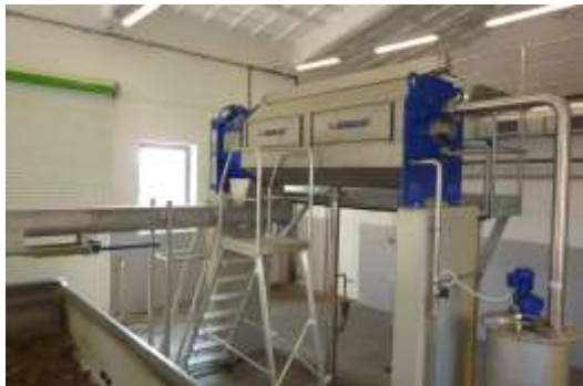
Odvodnění kalu – šnekolis
