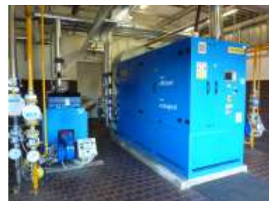
Kotelna se strojovnou
