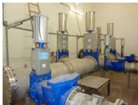
Vstupní čerpací stanice - technologie
