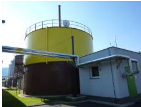
Suchý plynovod se strojovnou
